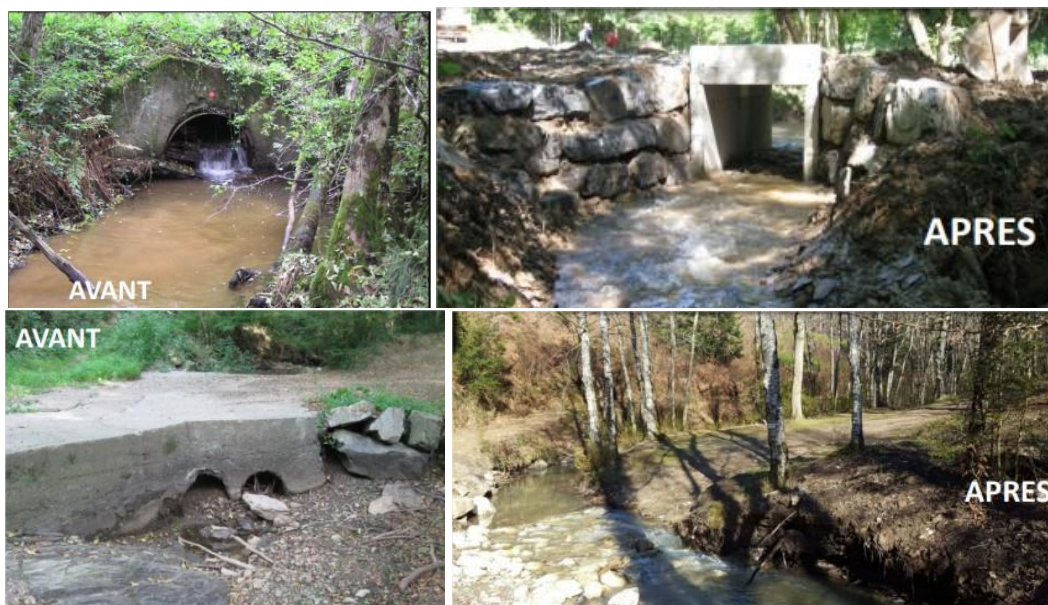
[Photos : Remplacement d'une buse par un pont cadre sur l'Oulas – Remplacement de buses par un passage à gué sur le Lézert de Sérénac (Source : Département du Tarn)]
