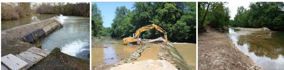
[Photos : Chaussée de Raillès, contexte Dadou aval, avant, pendant et après travaux]
