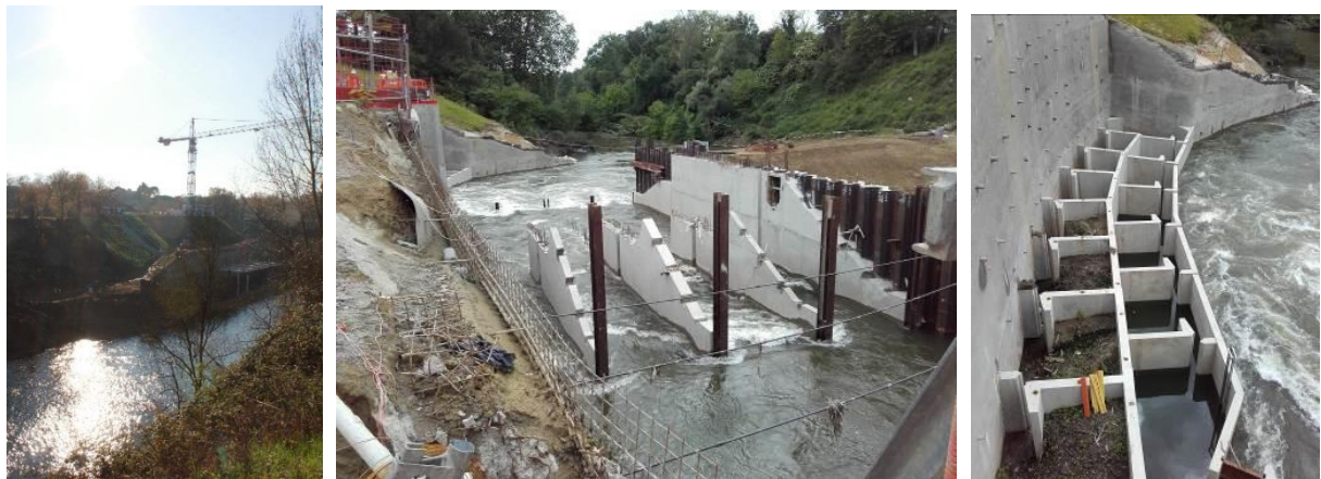
[Photos : Chantier du barrage d'Ambres-Fonteneau vu de l'amont en rive droite en 2016 et chantier en mai 2017]
