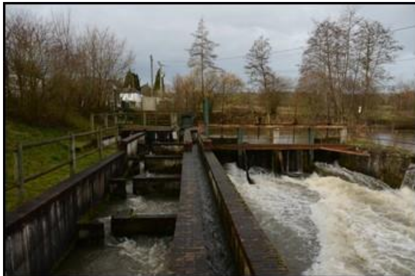
Figure 3 : Passe à bassins successifs du barrage du Breuil-en-Auge
