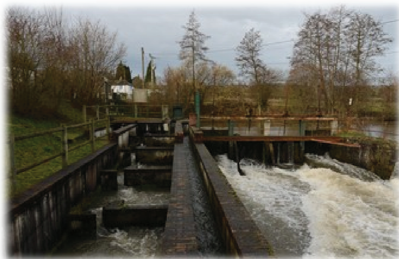
Figure 3 : Passe à bassins successifs du barrage du Breuil-en-Auge
