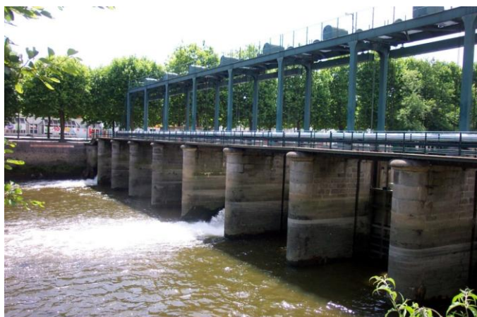
Figure 9: Barrage de Caen situé sur le Cours Montalivet servant à alimenter et réguler le niveau d'eau du canal de Caen à la mer. Premier obstacle du plus grand fleuve bas-normand, situé à près de 18 kilomètres de la limite transversale de la mer, l'ouvrage marque ainsi le fond de l'estuaire de l'Orne. (© Arnaud RICHARD – ONEMA).
