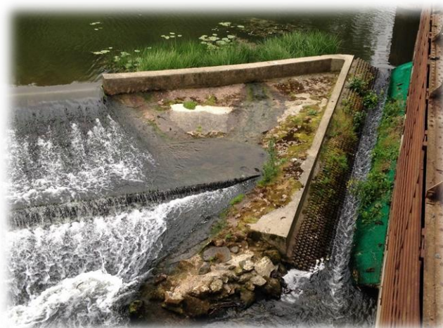
Figure 42 : Rampe anguille au niveau du barrage du Grand Moulin
