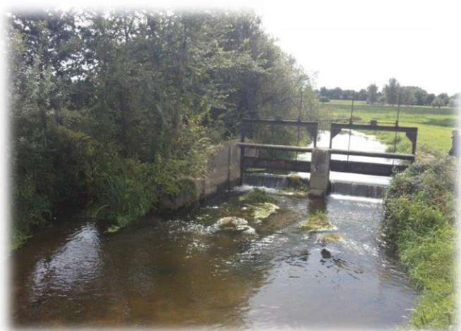
Figure 35 : Vannes de la Clergerie
