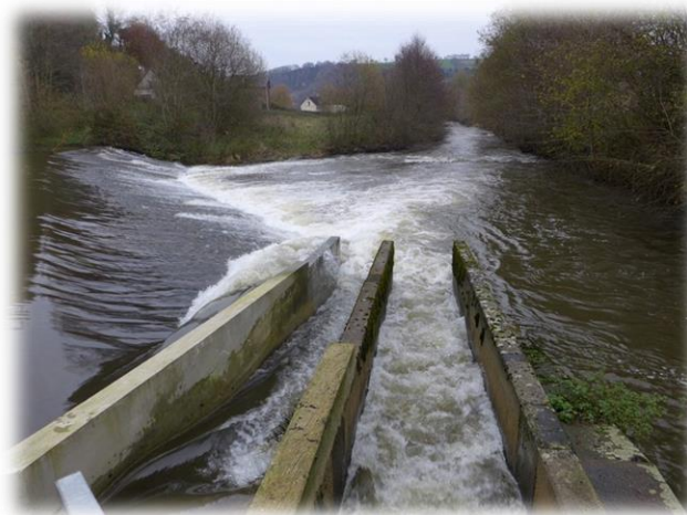
Figure 16: Passe à poissons au niveau du seuil de dérivation de la microcentrale de Pont-Farcy
