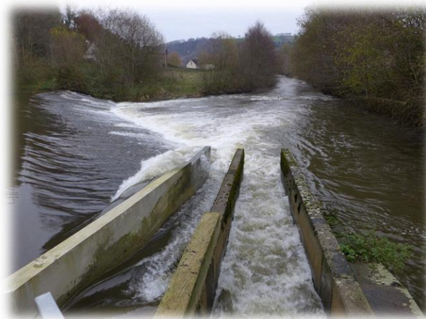
Figure 17: Passe à poissons au niveau du seuil de dérivation de la microcentrale de Pont-Farcy
