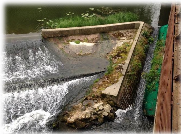
Figure 35 : Rampe anguille au niveau du barrage du Grand Moulin
