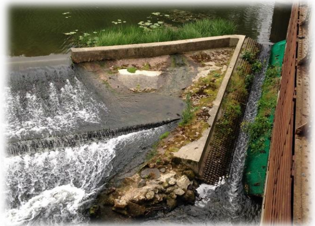
Figure 29 : Rampe anguille au niveau du barrage du Grand Moulin
