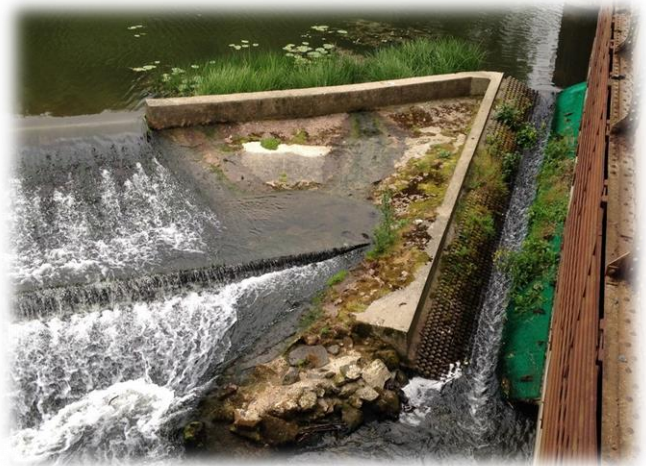
Figure 31 : Rampe anguille au niveau du barrage du Grand Moulin
