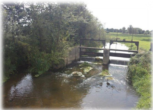
Figure 22 : Vannes de la Clergerie
