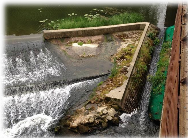
Figure 32 : Rampe anguille au niveau du barrage du Grand Moulin
