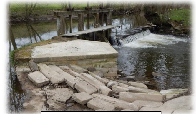
Ouvrage répartiteur, vannes fermées
