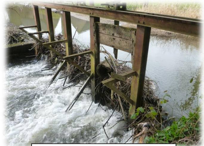
Portique chargé d'encombres après une crue
