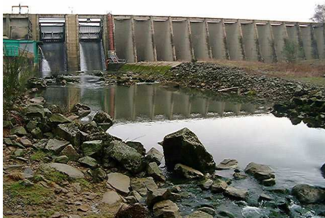
Figure 7 : Barrage à voûtes multiples et contreforts de la centrale hydroélectrique EDF de Rabodanges (département de l'Orne). Achevé en 1959, haut de 20 mètres et long de 160 mètres, l'ouvrage, toujours pas équipé à ce jour de dispositif de franchissement piscicole, condamne ainsi l'accès aux espèces amphihalines à près de la moitié du bassin de l'Orne.
