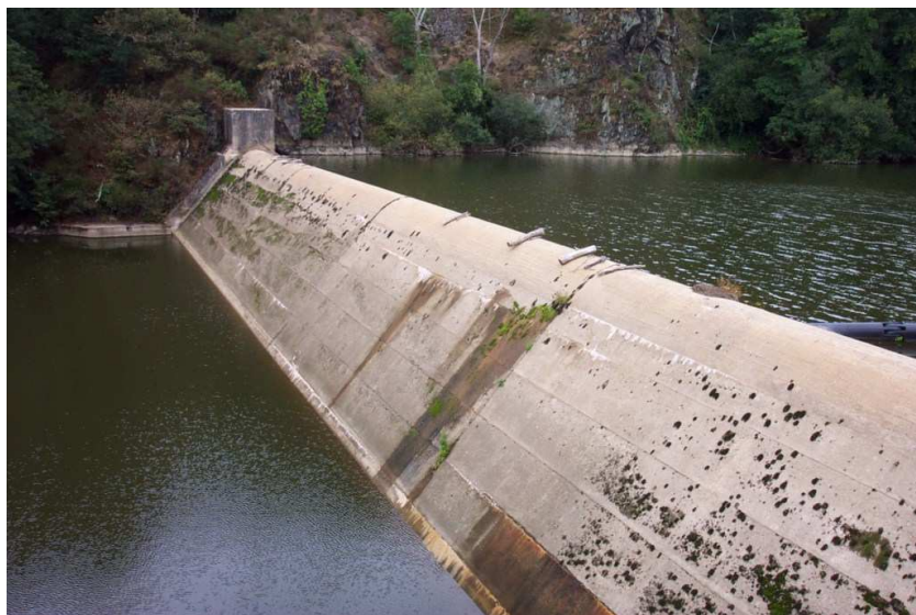
Figure 12 : Barrage de la centrale hydroélectrique EDF de Saint-Philbert, qui marque le front de colonisation active de l'anguille européenne sur le bassin de l'Orne et à l'amont duquel, sur le tronçon de cours d'eau soumis aux éclusées du barrage de la centrale hydroélectrique EDF de Rabodanges, la population est résiduelle, voire quasi-absente au regard des effectifs qui y ont été capturés. (© Arnaud RICHARD – ONEMA).
